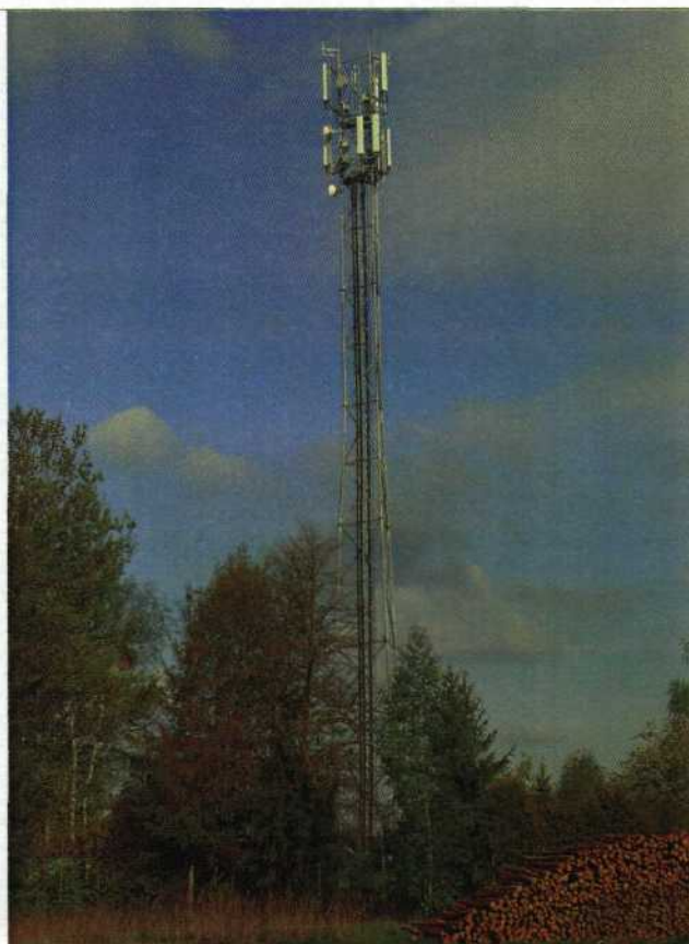
Fot. 1. OM Pionki / ul. Augustowska 6 – widok wieży z anteną linii radiowej
