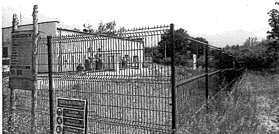
Ogrodzenie terenu podstacji 110/15/3 kV PT Bartodzieje
