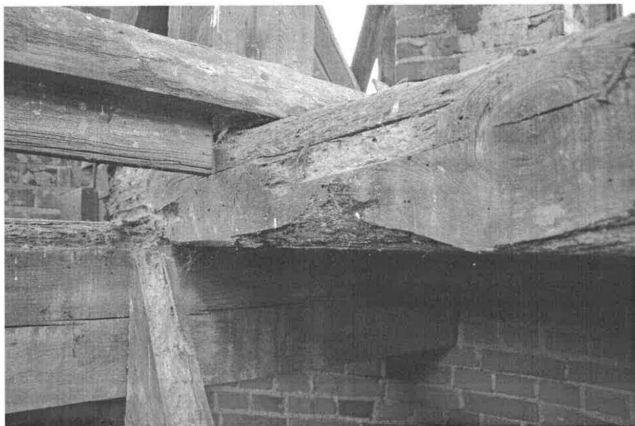
28. Zniszczone belki w wieży pod dzwonami.
