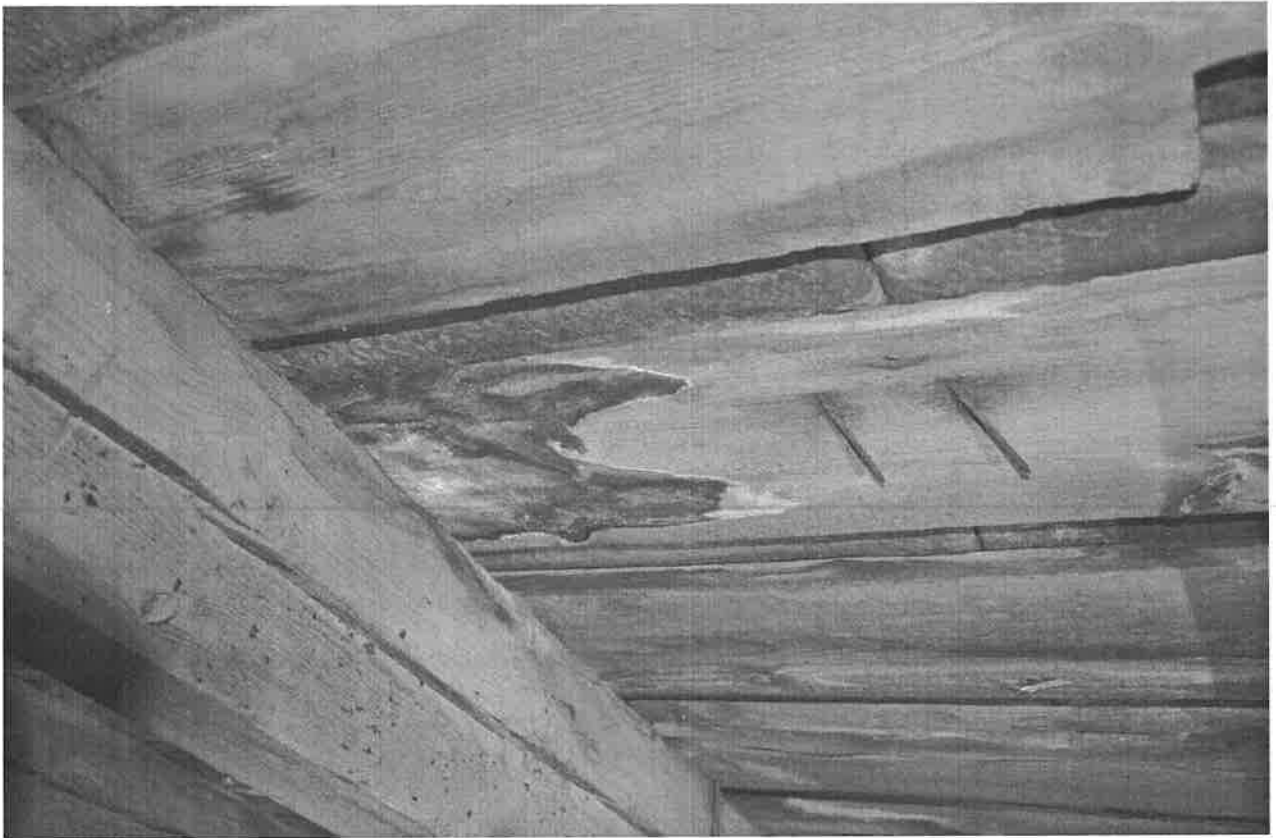
21. Ślady przecieków pokrycia dachowego.
