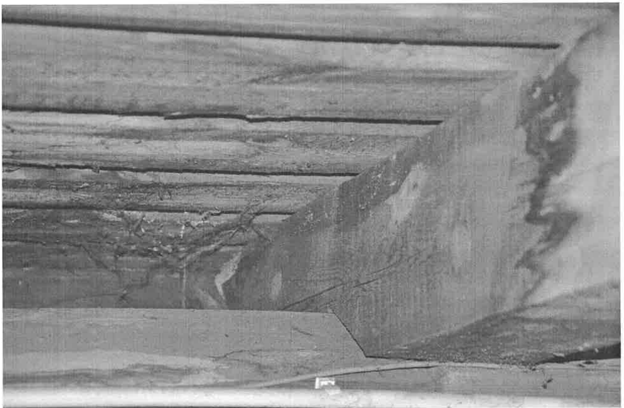
22. Ślady przecieków pokrycia dachowego.
