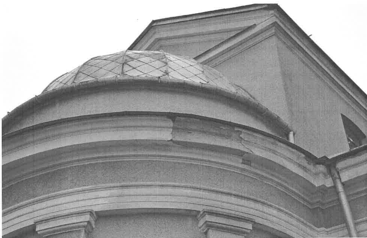
9. Uszkodzenia gzymsu od strony wschodniej.
