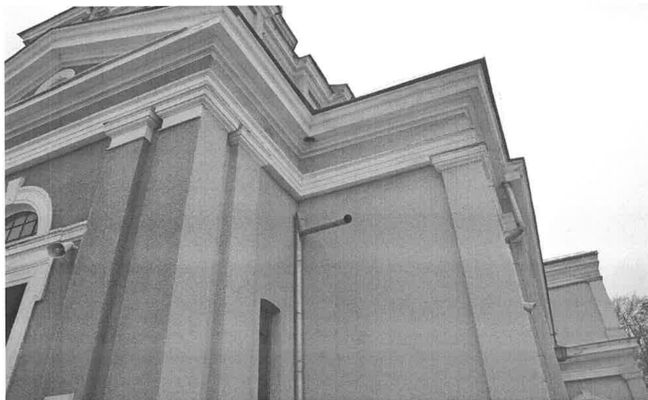
6. Uszkodzenia rury spustowej przy narożniku południowym.
