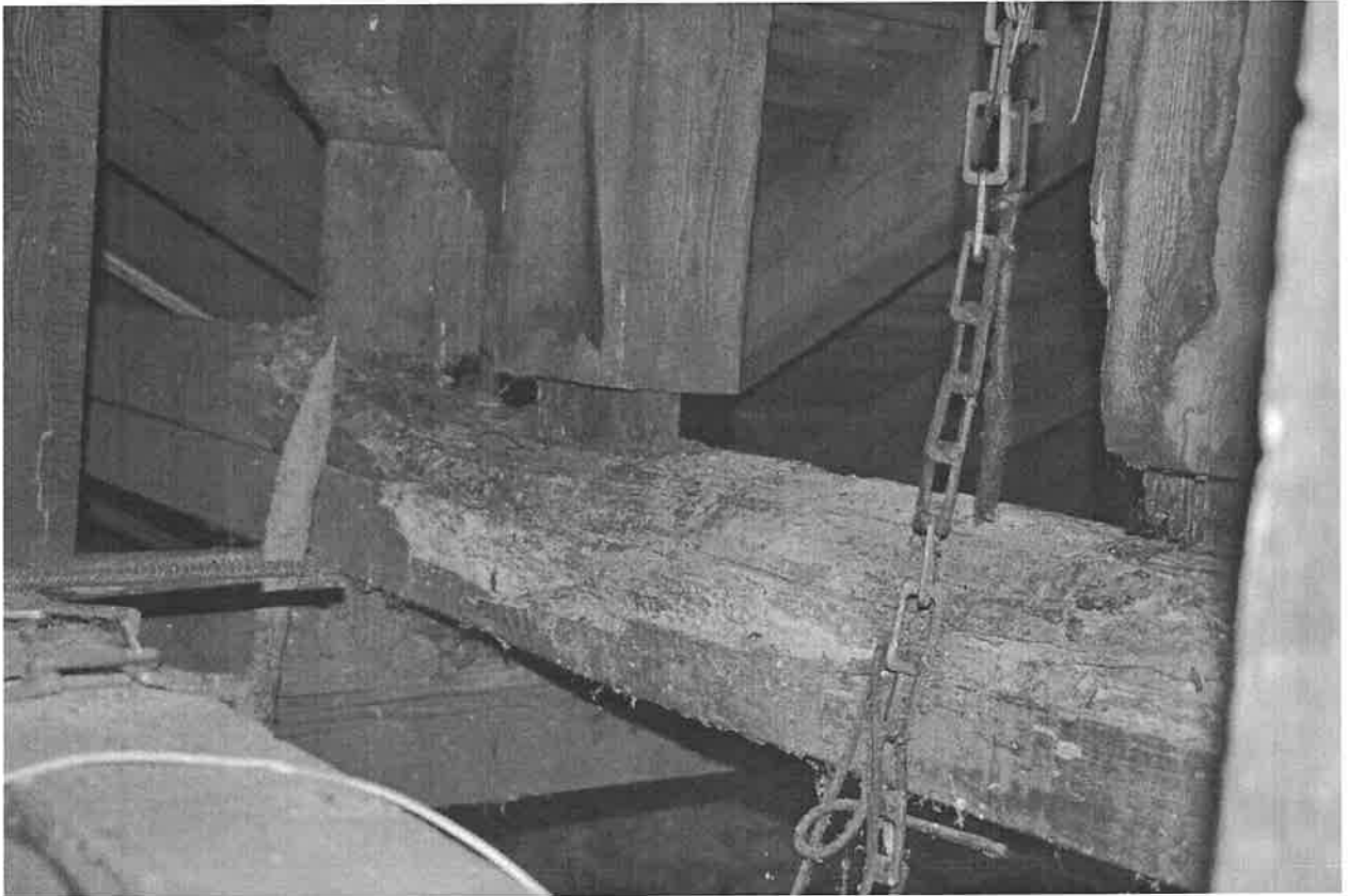
23. Zniszczona belka południowa pod sygnaturką.
