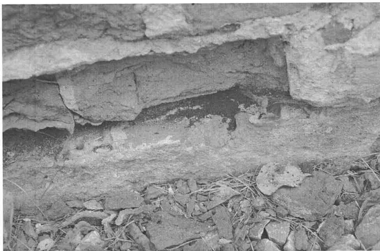
12. Uszkodzenia cokołu od strony północnej (szczegół).
