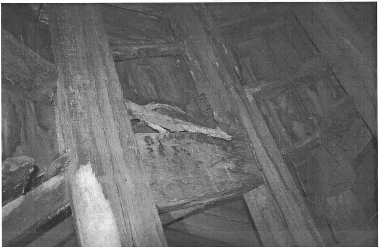
24. Zniszczone słupki i poszycie drewniane sygnaturki.
