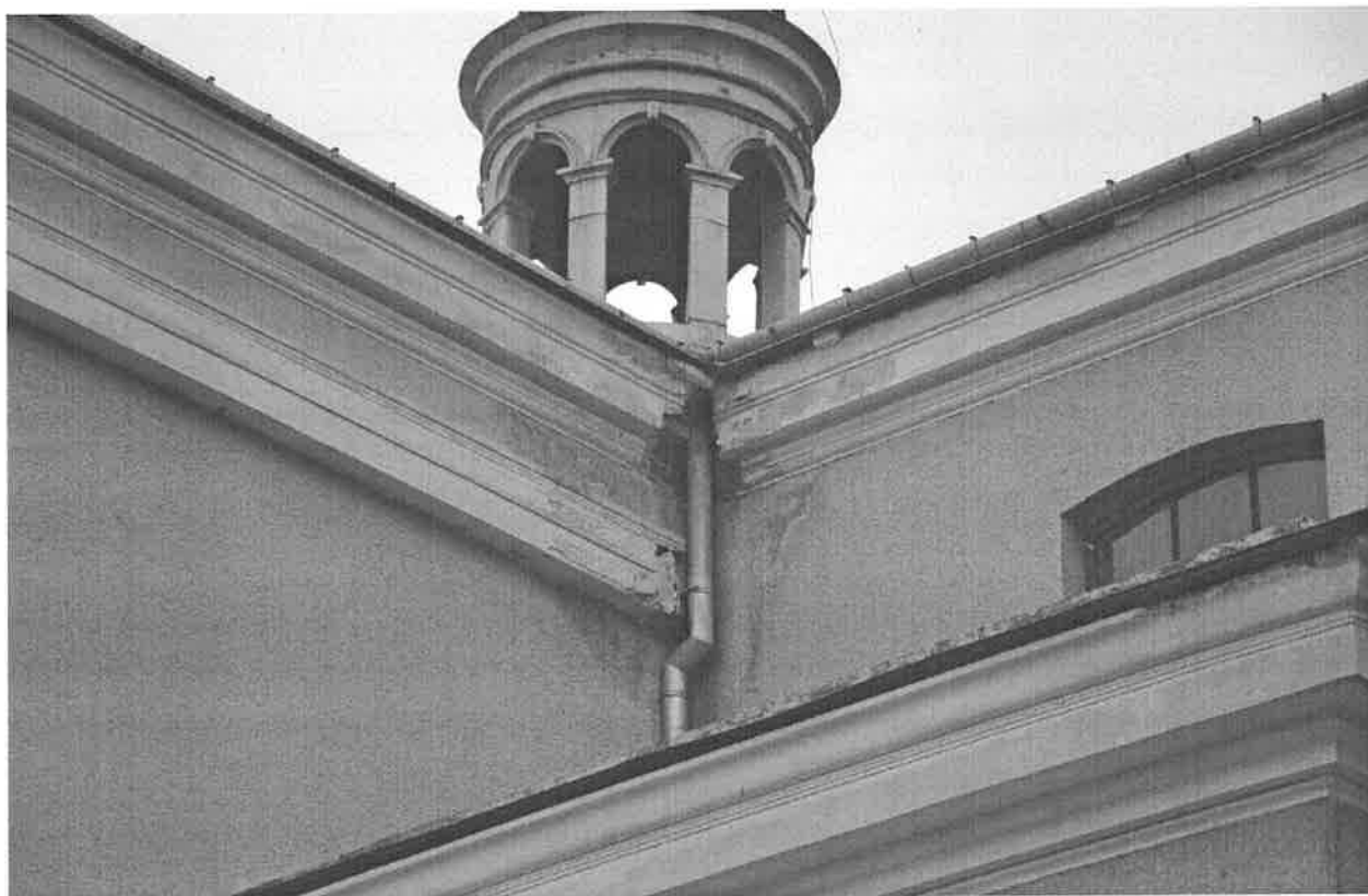
7. Uszkodzenia gzymsów przy narożniku południowym.
