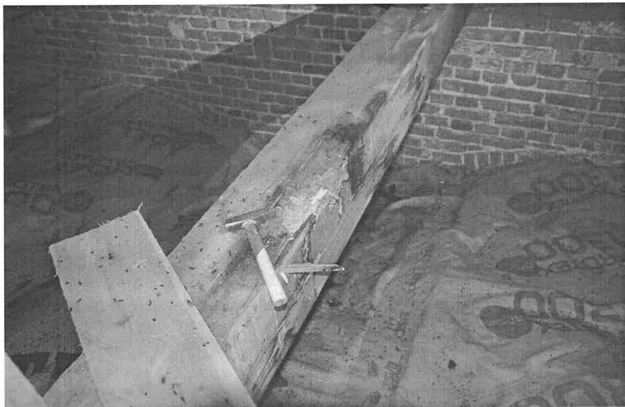
20. Uszkodzenia ściągu dolnego wieszara.
