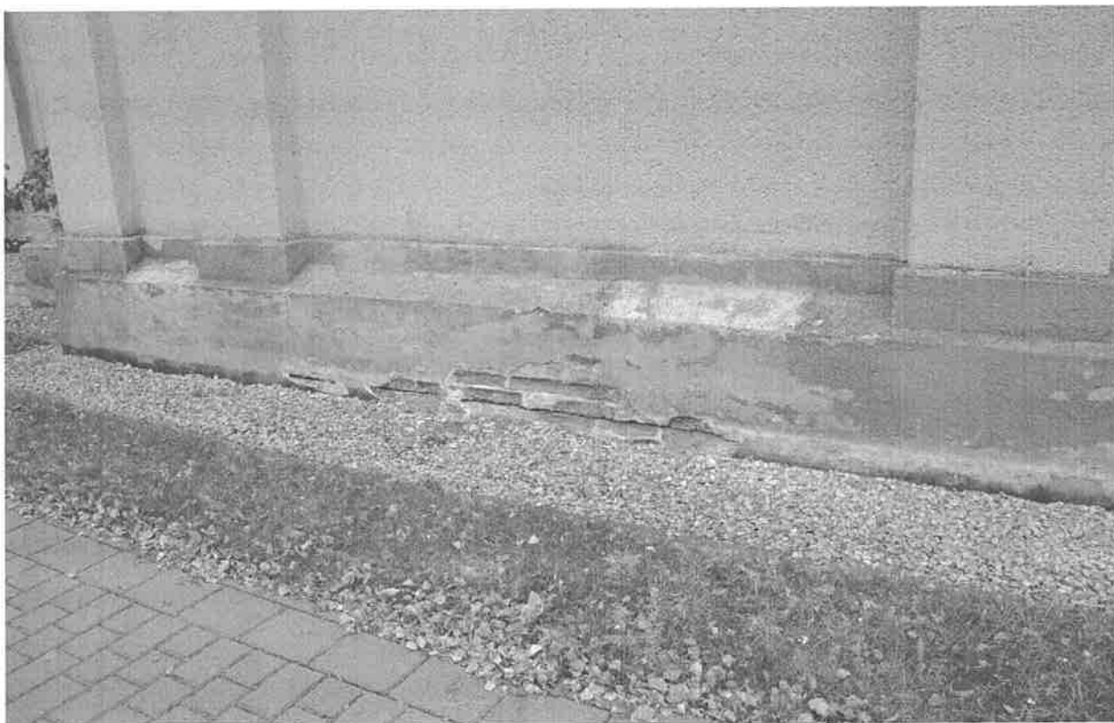
11. Uszkodzenia cokołu od strony północnej.
