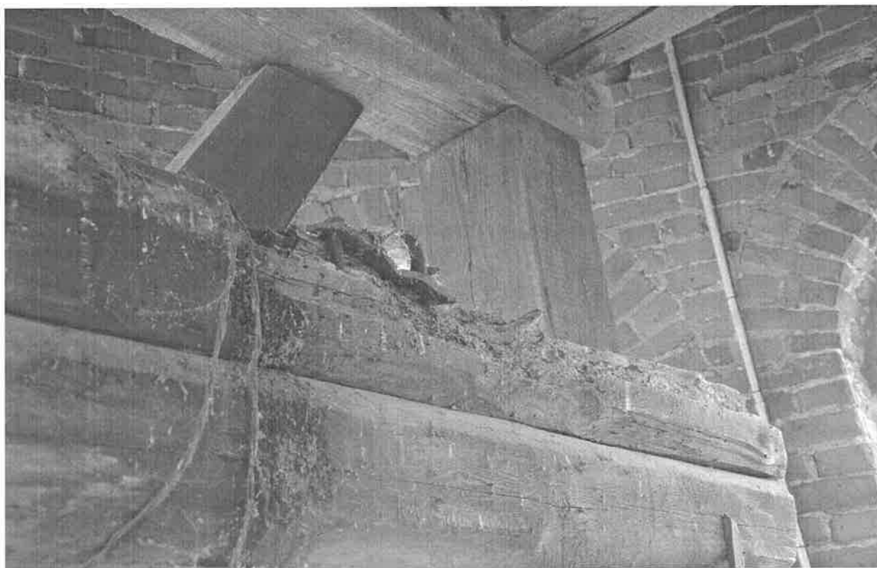
27. Zniszczone belki w wieży pod dzwonami.
