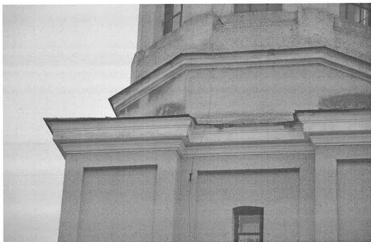
14. Uszkodzenia gzymsów i obróbek blacharskich.
