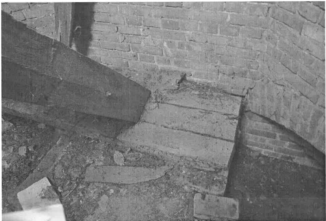
26. Zniszczona podwalina schodów w wieży pod dzwonami.
