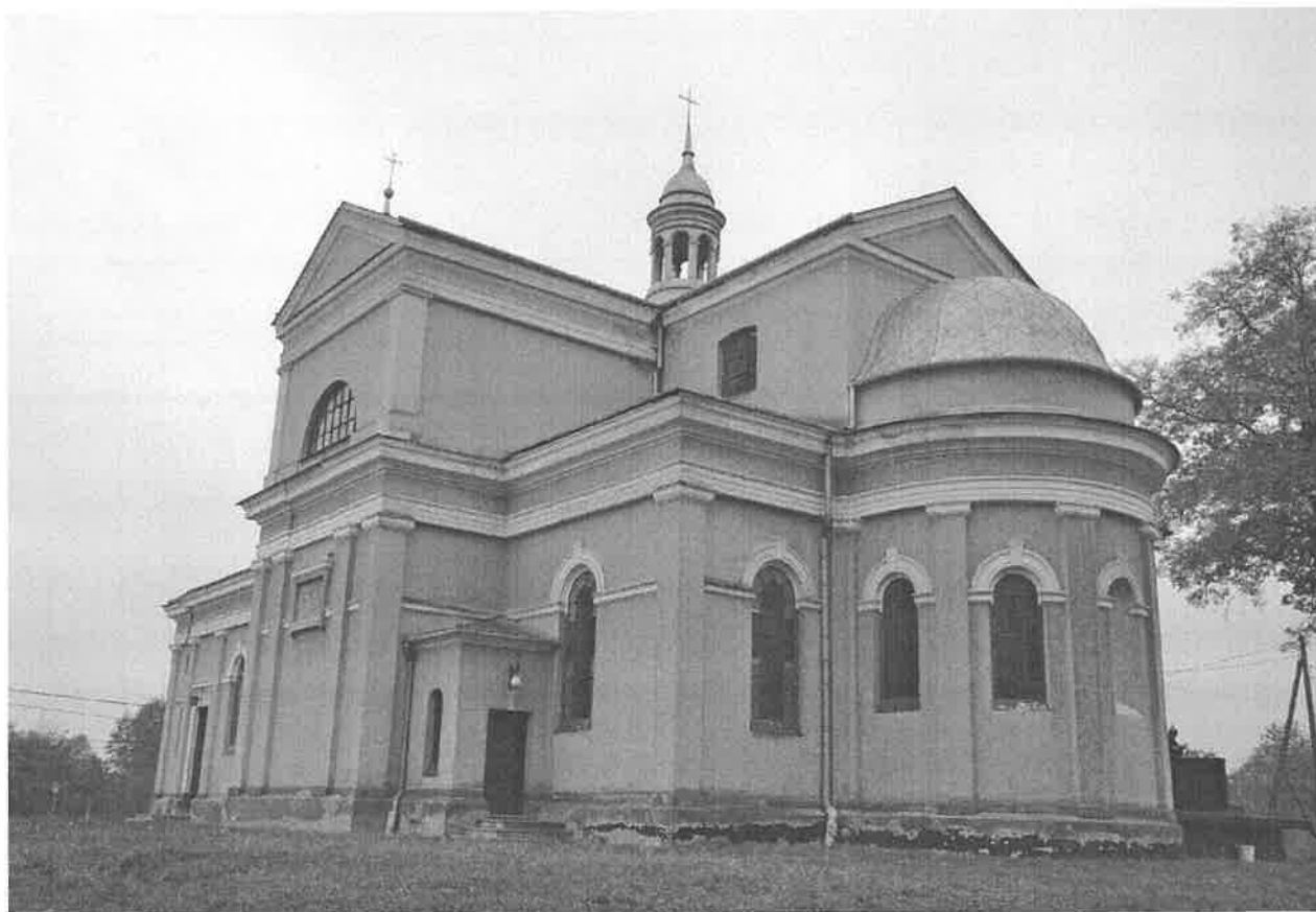
13. Uszkodzenia cokołu i gzymsów.
