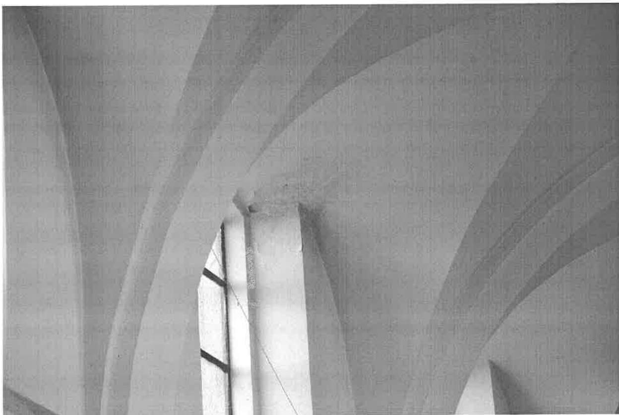
17. Ślady po przeciekach dachu od strony zachodniej.
